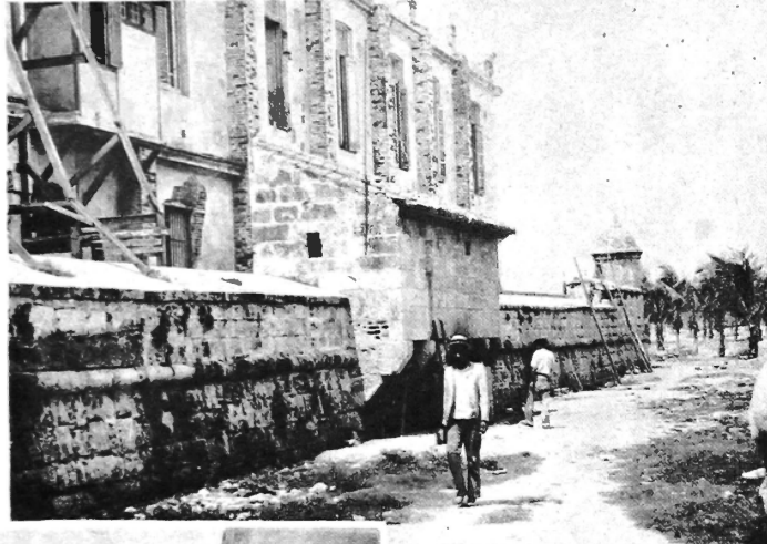
Vista general del lienzo de muralla marítima al fondo de la Maestranza, que será destruido próximamente, menos la garita y un trozo del bastión. Desde estas fortificaciones se peleó y murió recientemente en 1762, cuando el ataque británico a La Habana.
